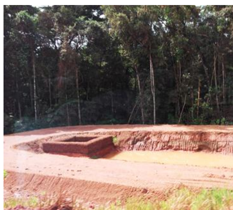
Foto 9: Tanque de rejeitos da extração de bauxita, INRC Quilombos Oriximiná. Nazareth, Alexandre. Porto Trombetas, Oriximiná – PA. 27/04/2013.
