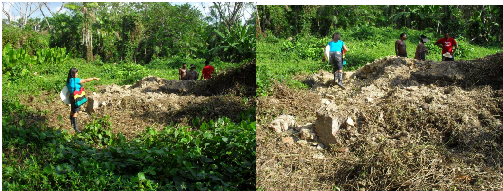
Figura 10. Sra. Ana Cristina F. da Silva aponta a destruição da parede do casarão.
