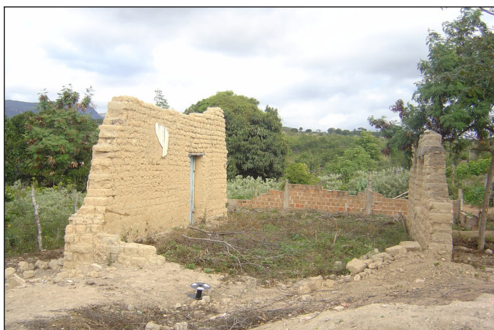
Foto 1: Antiga Igreja da localidade em ruína (A2-1574)
