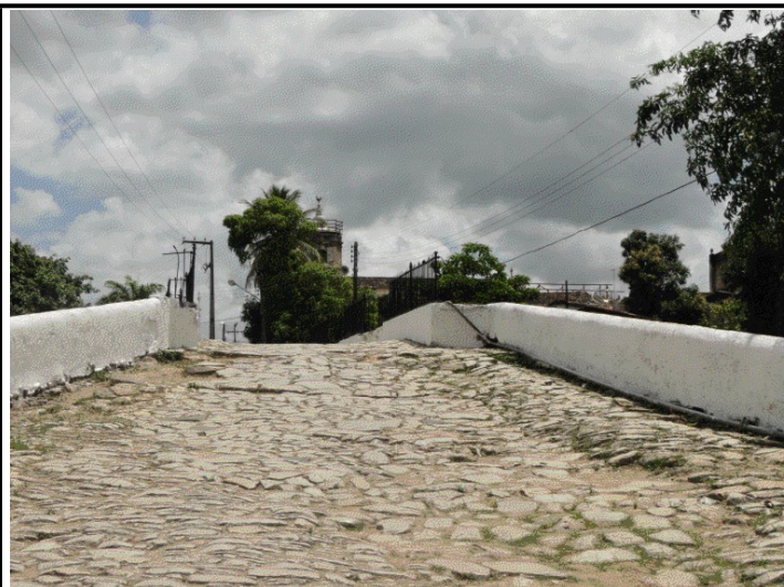
Legenda: Vista da cabeceira voltada para o antigo matadouro (Rua dos Caianos) onde se vê o precário estado de conservação da pavimentação em pedra calcária.
