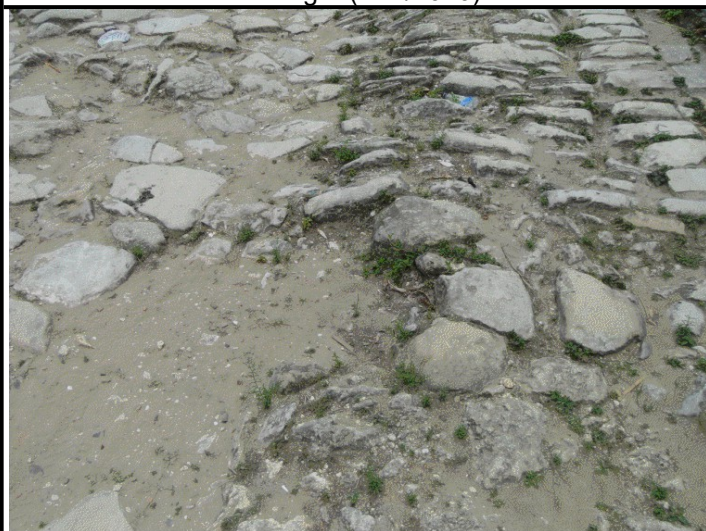
Legenda: Detalhe de deterioração do piso Foto: Fernando Montenegro (Dez/2010)
