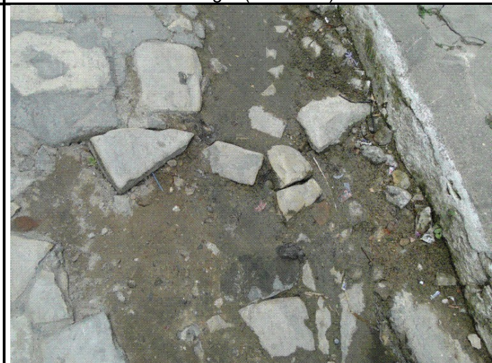
Detalhe da deterioração na Traversa Liberdade Foto: Fernando Montenegro (Dez/2010)
